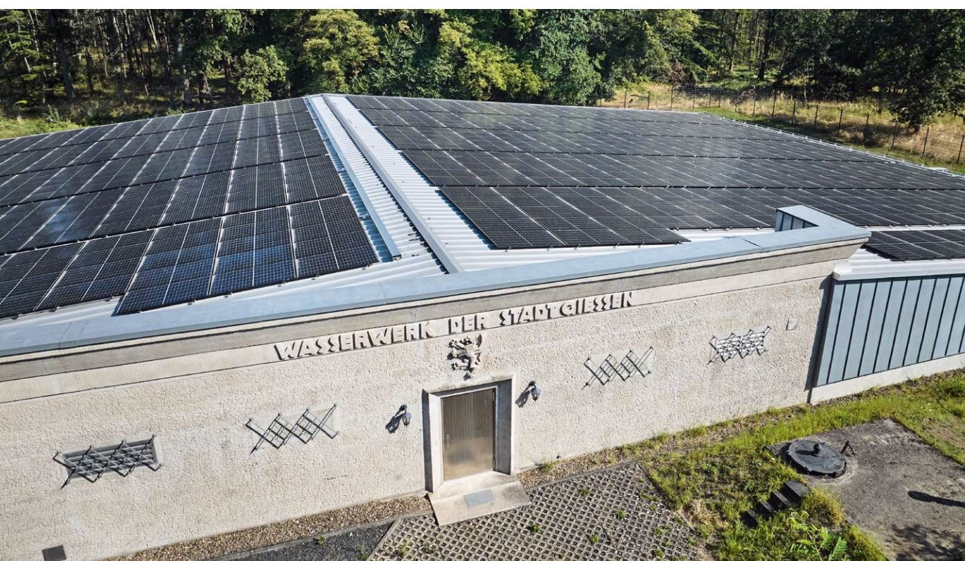
Die SWG haben auch auf dem Wasserhochbehälter in Fernwald eine Photovoltaik-Anlage installiert.
