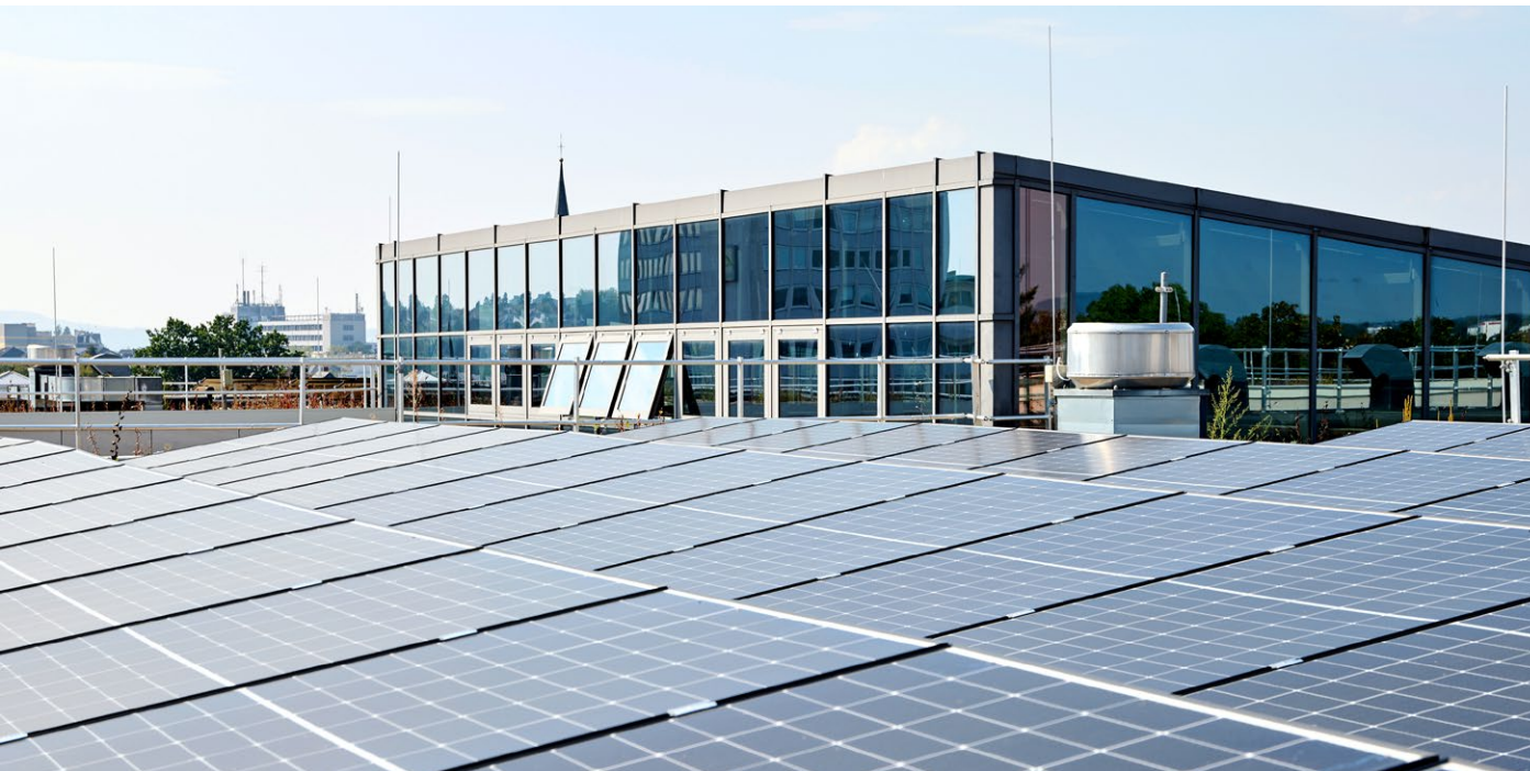
Die PV-Anlage auf dem Gießener Rathaus ging im Juni in Betrieb. Sie leistet 86,4 Kilowatt Peak.
